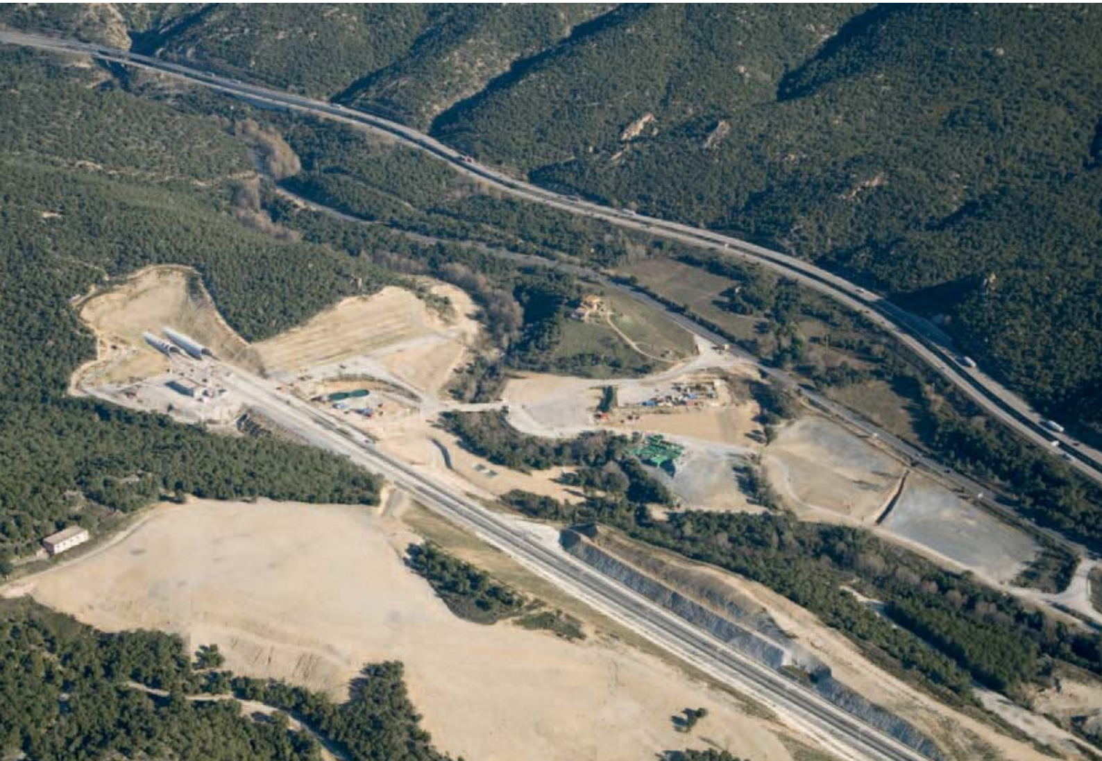
Línea de Alta Velocidad Figueras - Perpiñán, un proyecto donde SENER es responsable de la línea completa hasta su puesta en marcha.
