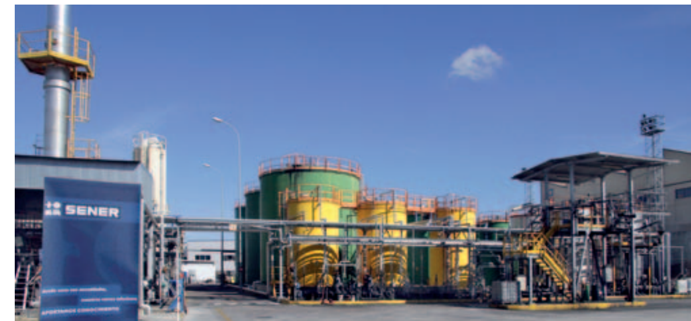
ECOLUBE's Plant storage area. / Planta de ECOLUBE, parque de almacenamiento.
