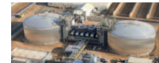
Sistema de almacenamiento en sales fundidas / Molten salts storage system
